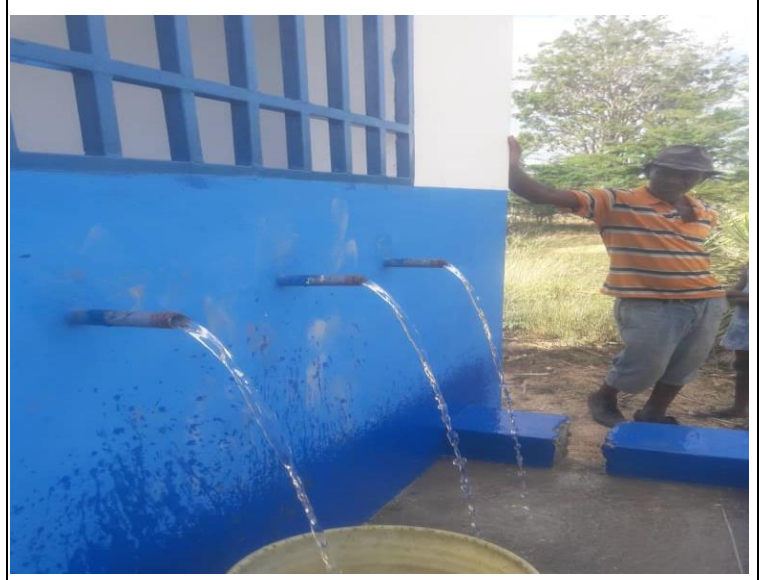
Grand Boucan – Borne fontaine, Système d'adduction d'eau potable
